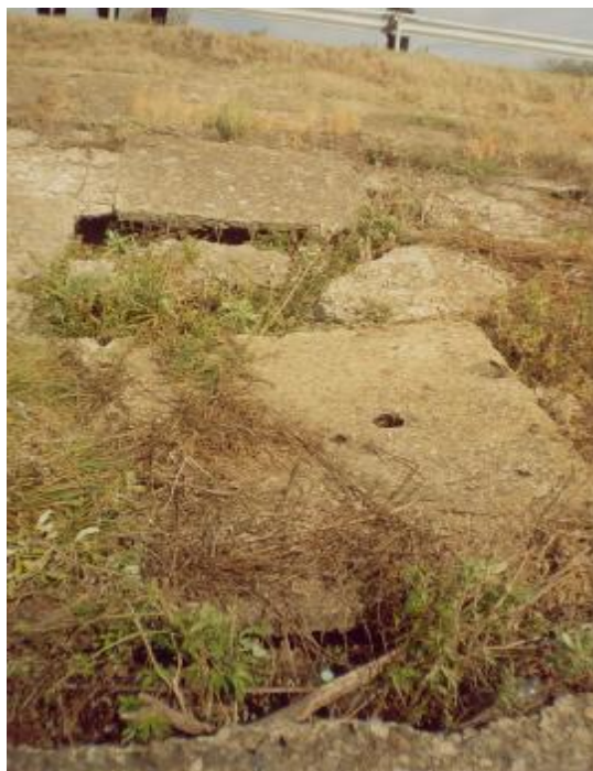
Рис. 2. Разрушения бетонного крепления верхового откоса плотины Октябрьского водохранилища
